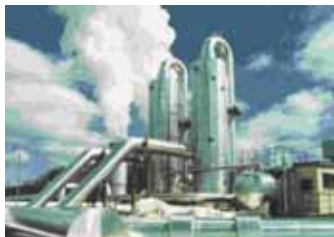
柳津西山地熱発電所 蒸気供給：奥会津地熱（株） 発電：東北電力（株）
